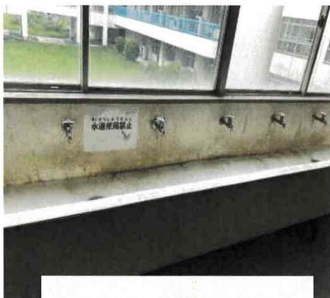
老朽化のため、使用禁止の手洗い場
